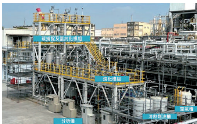
台塑仁武廠煙道氣化學固碳試驗工廠
