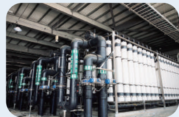
超濾產水設備
