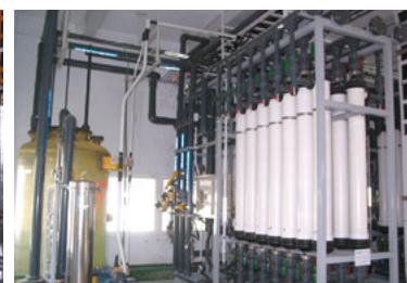
廢水回收設備 UF 膜組
