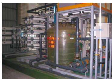
廢水回收設備 RO 膜組
