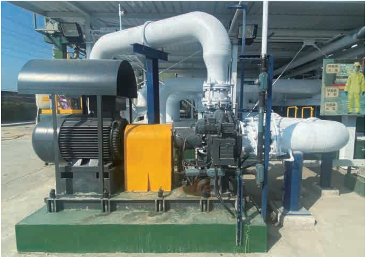
台化新港廠區七十五 kW 之水輪發電機組（十月二十七日投入運轉）
