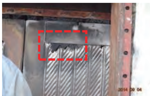
圖五 熱交換片遭煙氣沖蝕(虛線區)
