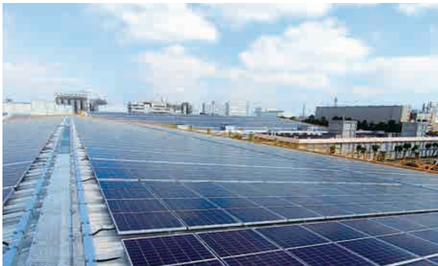
新港配電盤廠屋頂
