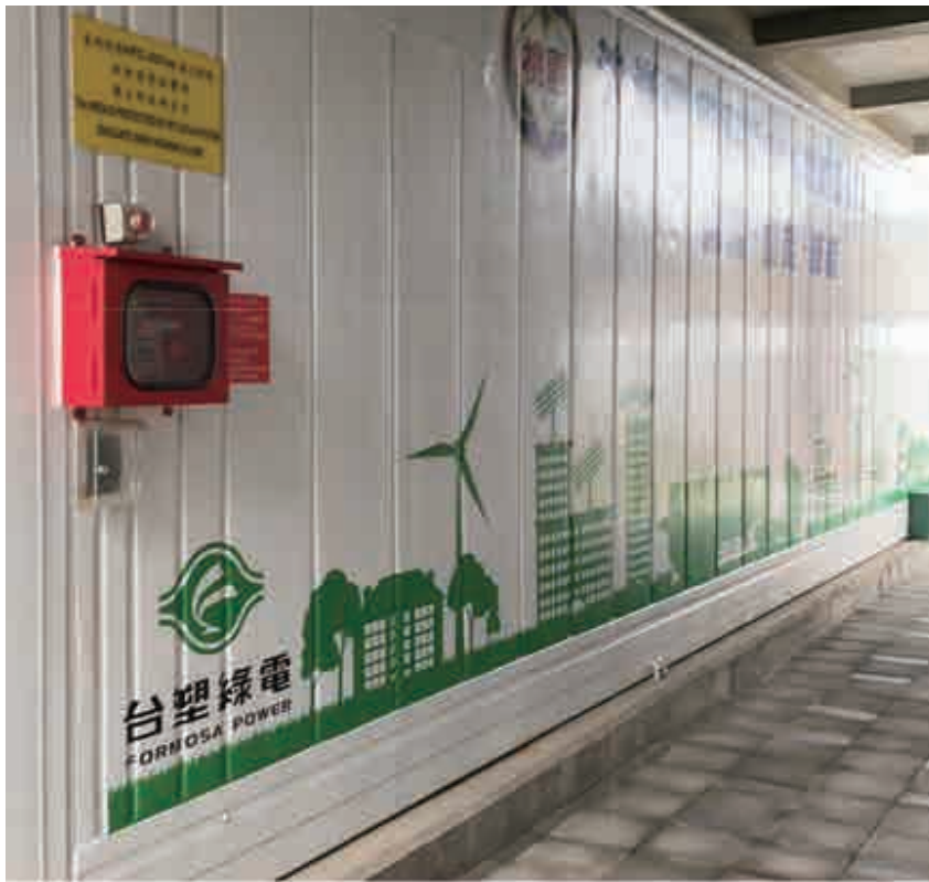
污水處理廠儲能櫃
