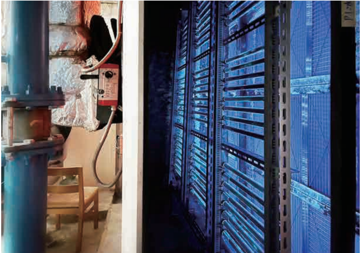
微風廣場美食街採用 NKFG 福機裝公司 UVC LED 空氣除菌模組實際安裝圖示
