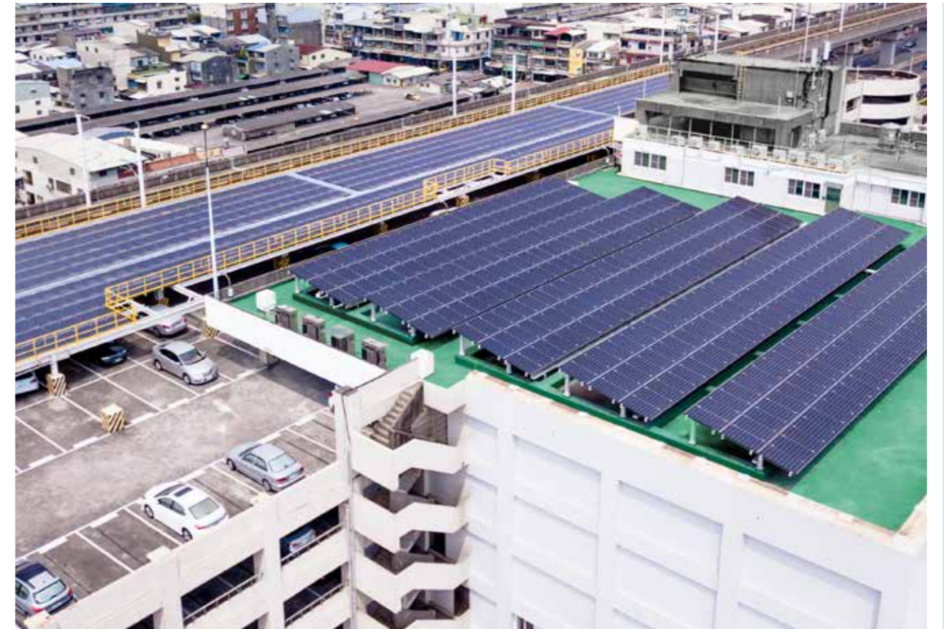
..... 高雄仁武廠太陽能發電
