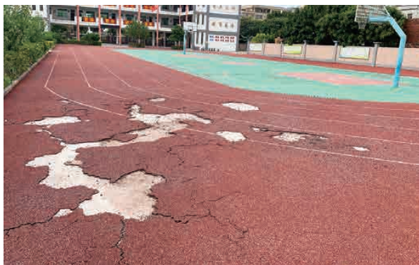
舊跑道出現龜裂、脫落情形
