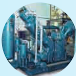
⑨ 空壓機改善
