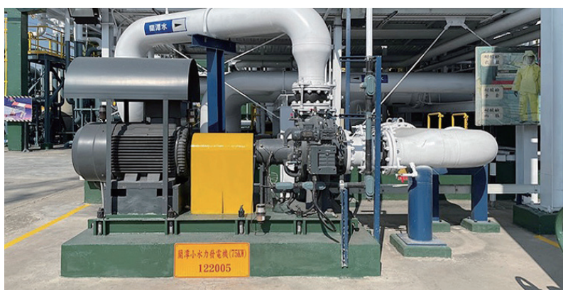
圖一 蘭潭小水力發電機
