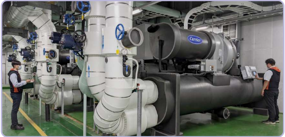
▲ 中央空調主機房採全變頻系統，搭配最佳化節能控制
