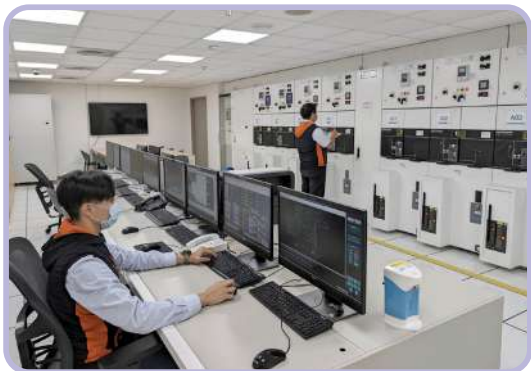
▲ 由中央監控室全天 24 小時監控各類機電設備運轉狀態
